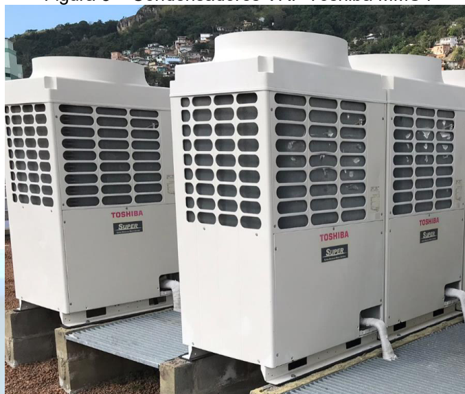
Figura 5 – Condensadores VRF Toshiba MMS-i
