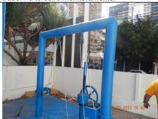
Foto nº 4731 de 21/02/2017 – A elevatória é invadida por terceiros, devido ter muro muito baixo.
