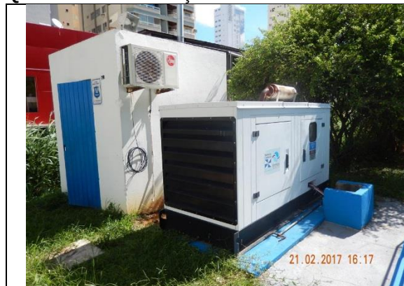
Foto nº 4715 de 21/02/2017 – Elevatória com gerador próprio.
