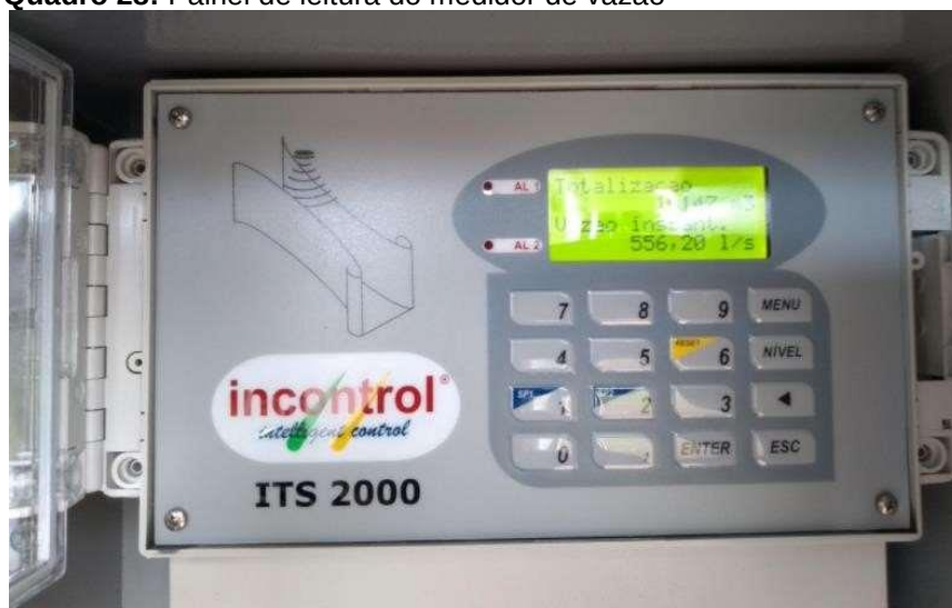
Quadro 28: Painel de leitura do medidor de vazão
