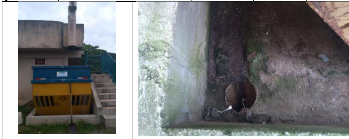
Quadro 23: Caçamba estacionária em local com ralo para retorno de líquidos em estação elevatória
