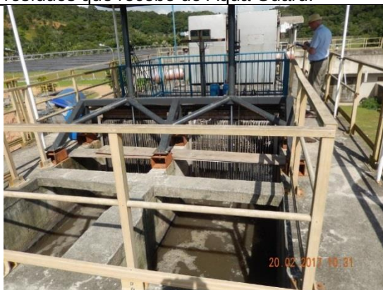
Foto nº 4459 de 20/02/17 – Grade mecanizada em teste, que retira os resíduos maiores.
