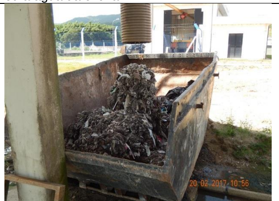
Foto nº 4500 de 20/02/17 – caçambas estacionárias que recebem o material grosseiro sem registro ou torneira para o vazamento do líquido percolado, que escorrem no solo da ETE.
