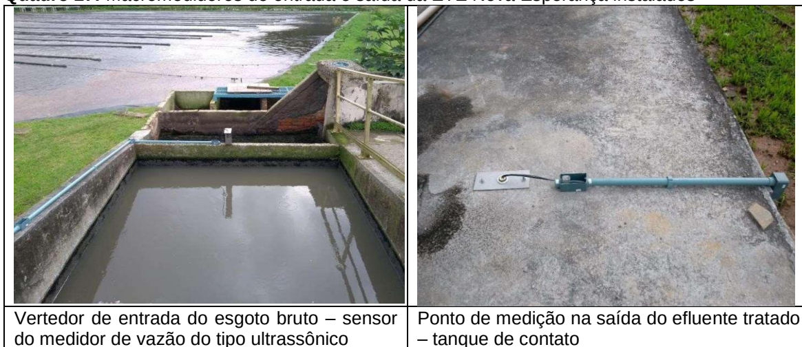
Quadro 27: Macromedidores de entrada e saída da ETE Nova Esperança instalados
