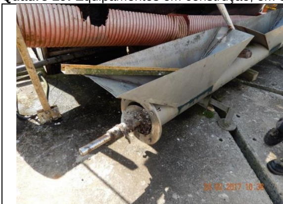
Foto nº 4470 de 20/02/17 – Rosca que conduz os resíduos sólidos com defeito, ao lado tubulação improvisada.
