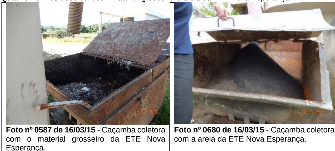
Quadro 13: Resíduos sólidos - material grosseiro e areia da ETE Nova Esperança.
