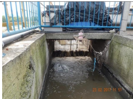
Foto nº 4900 de 23/02/17 – sensor de nível do Aqua Guard e aos fundos a grade mecanizada em teste, que retira os resíduos maiores.
