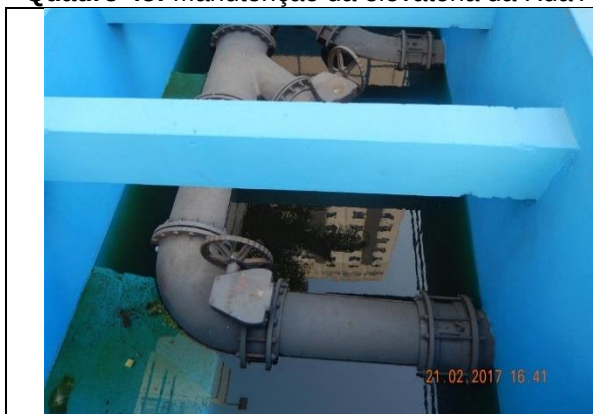
Foto nº 4733 de 21/02/2017 – Água no valo da tubulação da elevatória de esgoto, que pode procriar mosquito da dengue.
