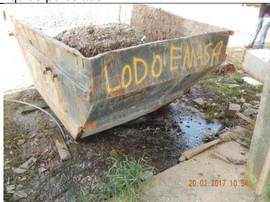
Foto nº 4497 de 20/02/17 – caçambas estacionárias que recebem o material grosseiro sem registro ou torneira para o vazamento do líquido percolado, que escorrem no solo da ETE.
