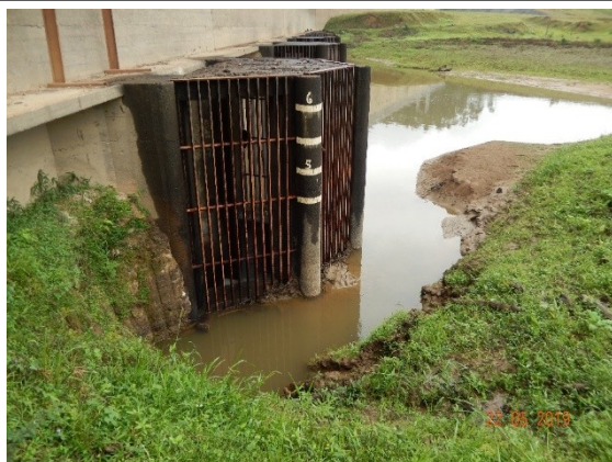
Foto DSCN0991: Tomada d'água.
