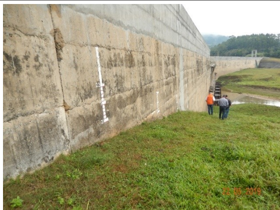
Foto DSCN0986: Paramento de montante sobre-elevado.
