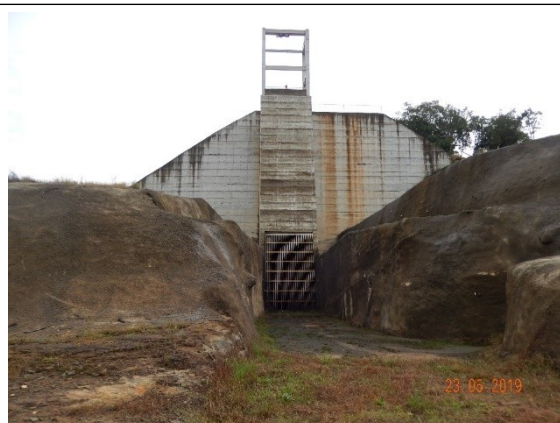
Foto DSCN1118: Entrada do canal extravasor lateral construído (vista frontal), com acionamento apenas por cabos (guincho).
