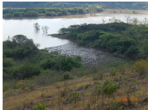
Foto DSCN3720: Detalhe da tomada d'água dos descarregadores de fundo permanentes (sem comporta), com material lenhoso em excesso.
