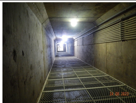
Foto DSCN4036: Galeria de inspeção. Dutos de acionamento do sistema hidráulico e piso metálico restaurados (com reforço).
