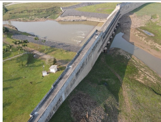
Foto DJI0625: Paramento de montante sobre-elevado.
