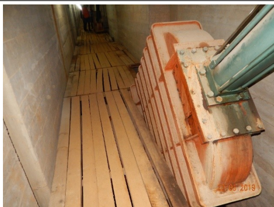
Foto DSCN1044: Galeria de inspeção. Madeiras continuam soltas e, em alguns casos, apodrecendo. Algumas ripas antigas foram trocadas por novas.
