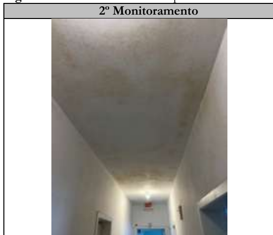
Figura 05 – Mofo em diversas dependências da UBS
