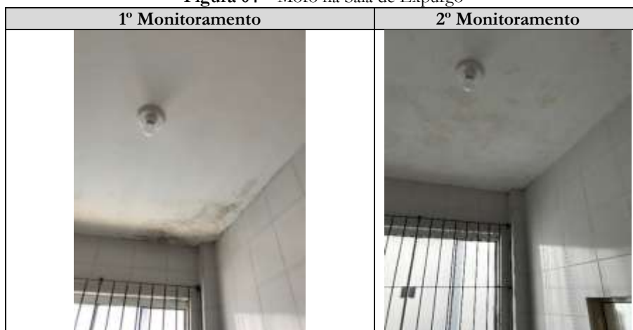
Figura 04 – Mofo na Sala de Expurgo
