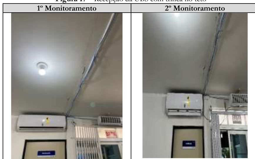
Figura 17 – Recepção da UBS com trinca no teto
