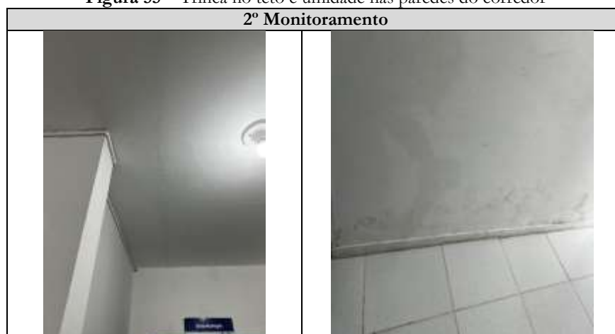
Figura 55 – Trinca no teto e umidade nas paredes do corredor
