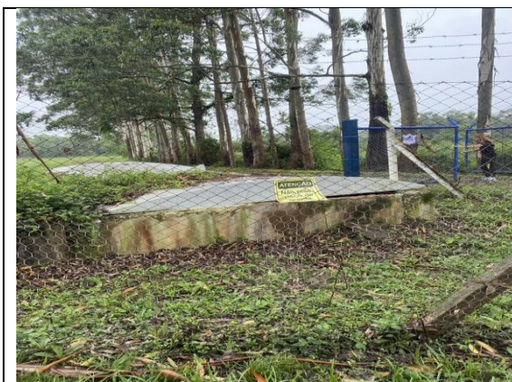
Foto nº 2167 de 11/12/2023 TCE – Placa de “Atenção: Não Pise. Risco de Queda” na Caixa de Entrada de Esgoto danificada.
