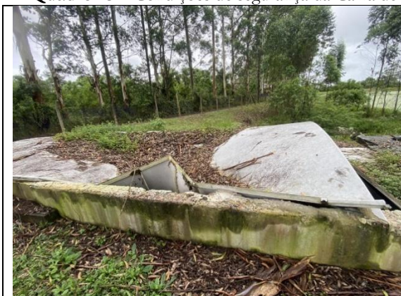
Foto nº 2136 de 11/12/2023 TCE – Caixa de Entrada de Esgoto danificada.
