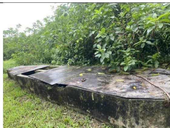
Foto nº 2145 de 11/12/2023 TCE – Leito de Secagem danificado.
