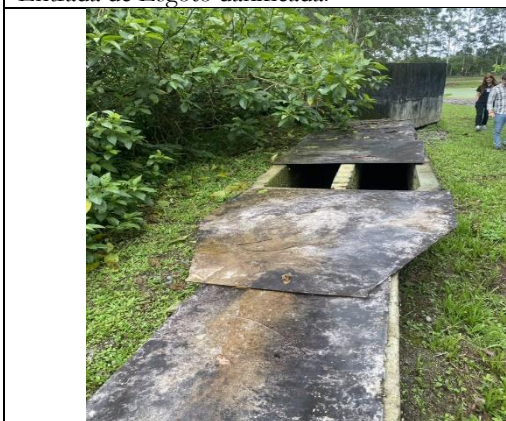
Foto nº 2146 de 11/12/2023 TCE – Leito de Secagem danificado.
