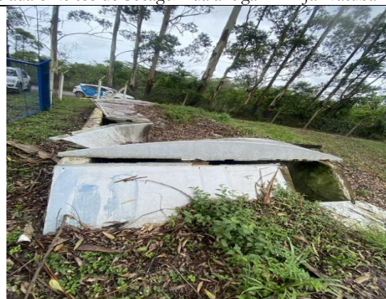
Foto nº 2137 de 11/12/2023 TCE – Caixa de Entrada de Esgoto danificada.
