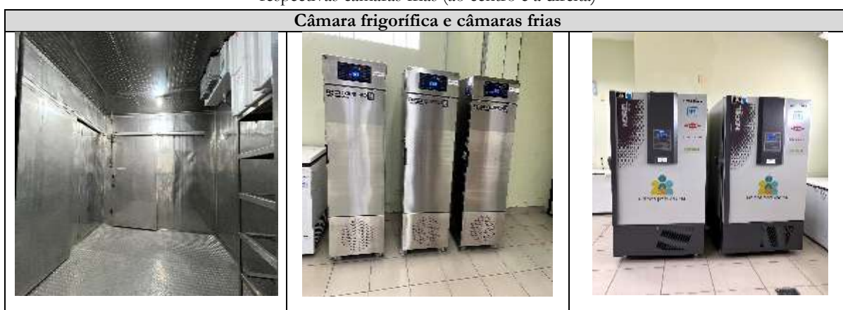
Fonte: TCE/SC, em execução in loco .
