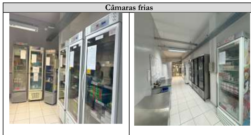
Imagem 03 – Câmaras frias da Central Municipal da Rede de Frio de Chapecó
