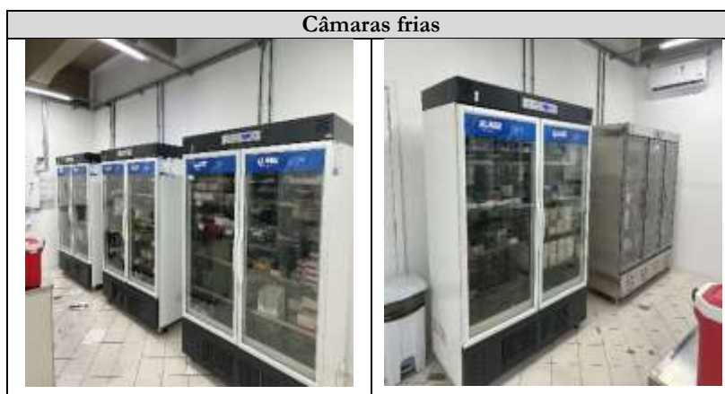
Imagem 05 – Câmaras frias da Central Municipal da Rede de Frio de Florianópolis
