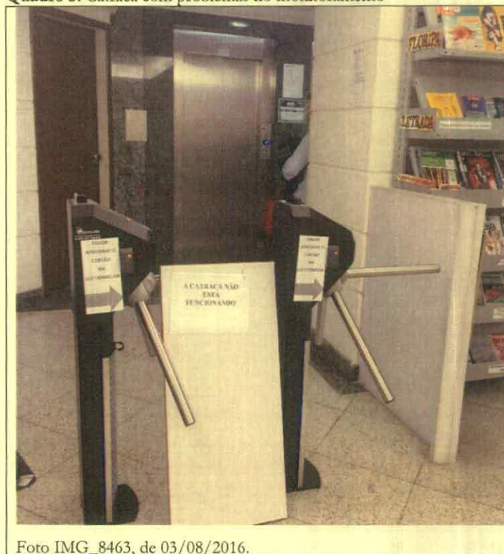
Quadro 3: Catraca com problemas no monitoramento
