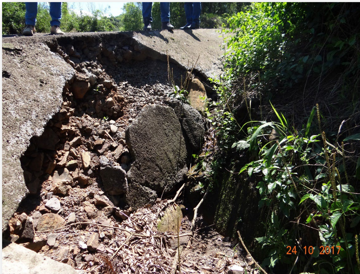
Ausência de sarjetas
