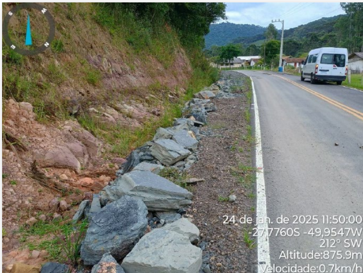
Ausência de drenagem – pavimento com 1 ano
