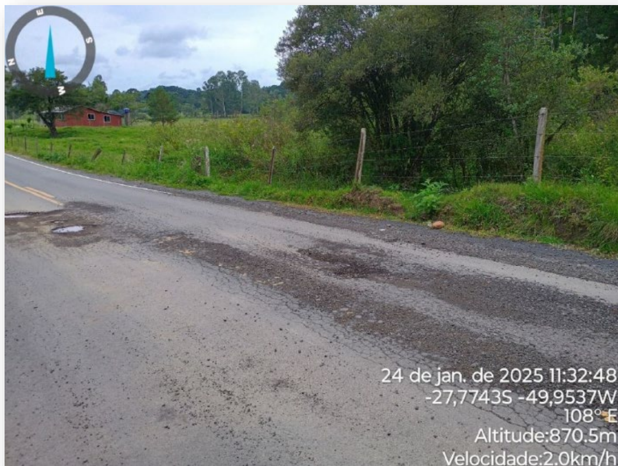
Ausência de drenagem – pavimento com 1 ano
