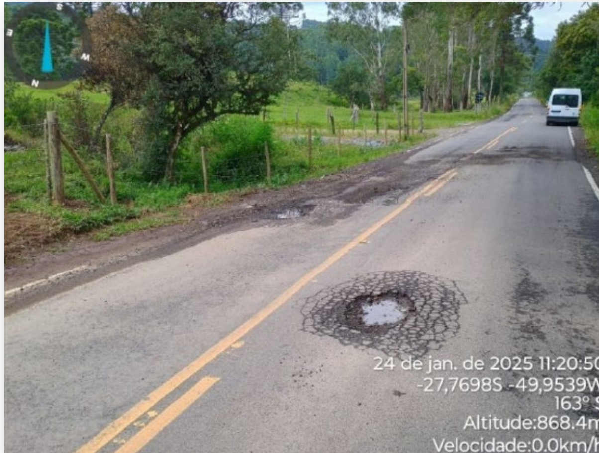
Ausência de drenagem – pavimento com 1 ano
