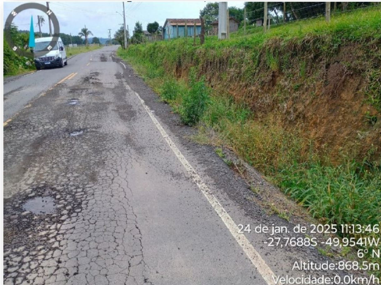
Ausência de drenagem – pavimento com 1 ano
