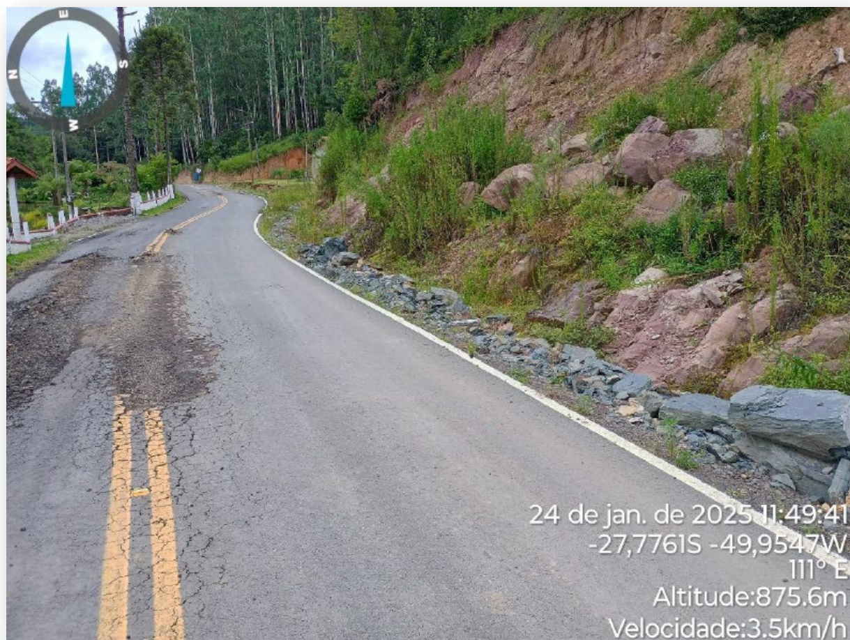
Ausência de drenagem – pavimento com 1 ano
