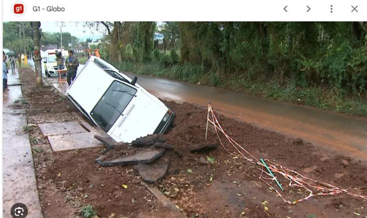
Motorista cai em 'cratera' de obra sem sinalização em estrada no distrito de Ribeirão Preto | G1
