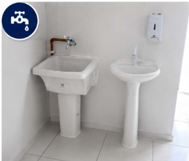
Instalação precária da torneira da pia do tanque
