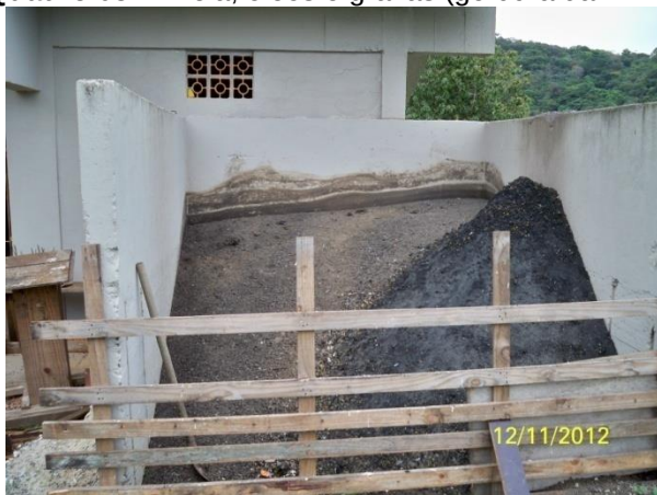
Foto nº 1506 de 12/11/12 – areia em compartimento direito junto ao conjunto da calha parshall.
