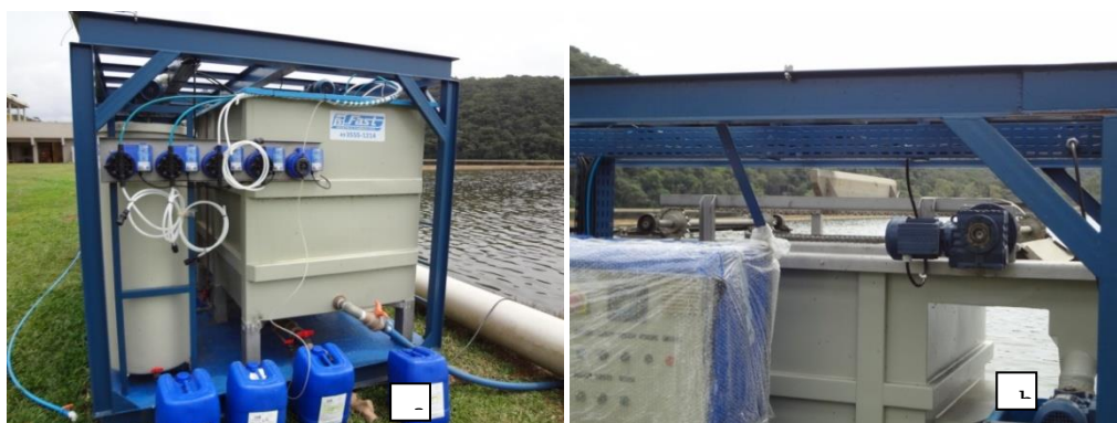
Figura 1: Processo de tratamento do lodo da lagoa facultativa 2. a) Entrada de lodo no equipamento e após receber o coagulante o efluente segue para o Flotador. b) Flotador: nesta etapa o lodo fica suspenso e é retirado, separando o lodo da água.
