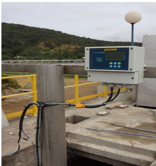
figura 6: Macromedidor de entrada, localizado na entrada do tratamento preliminar.
