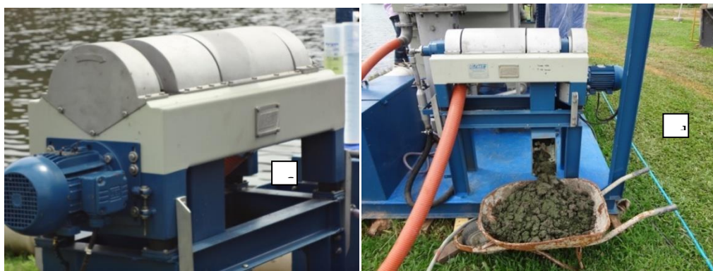
Figura 2: Processo de tratamento do lodo da lagoa facultativa 2. c) O lodo passa do flotador para uma centrífuga que retira parte da umidade existente através do processo de centrifugação. d) O lodo sai da centrífuga com umidade em torno de 70% – 80%. Após a centrifugação o lodo pode ser seco em um secador industrial, baixando a umidade do lodo para até 15%.
