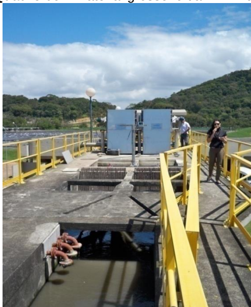
Foto nº 2843 de 08/10/12 – Material grosseiro é o primeiro resíduo sólido que chega ETE e fica preso nos gradeamentos mecanizado ou não, um
