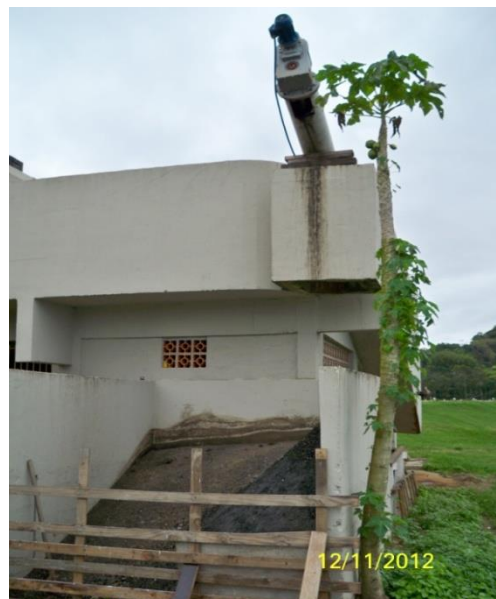
Foto nº 1508 de 12/11/12 - Local onde a areia cai antes de ser retirada.
