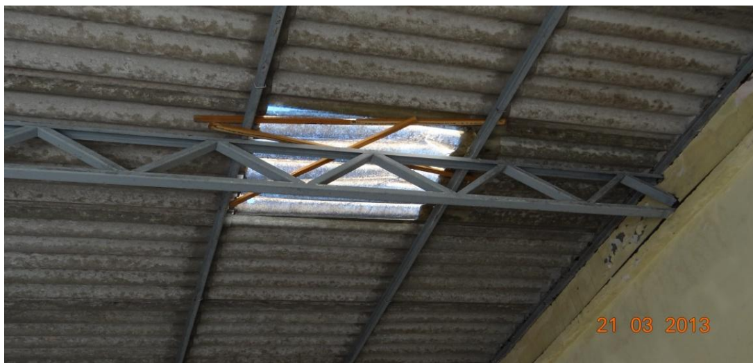
TELHADO EXISTENTE ENTRE O GINÁSIO DE ESPORTES E PRÉDIO DAS SALAS DE AULA COM "REMENDOS" INDEVIDOS OS QUAIS PROPORCIONAM O SURGIMENTO DE GOTEIRAS NESTA ÁREA.
