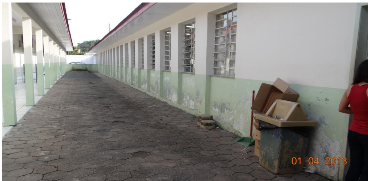
PINTURA DA ESCOLA ENCONTRA-SE DETERIORADA. PROBLEMAS DE DRENAGEM CONTRIBUEM PARA UMIDADE NAS PAREDES.
