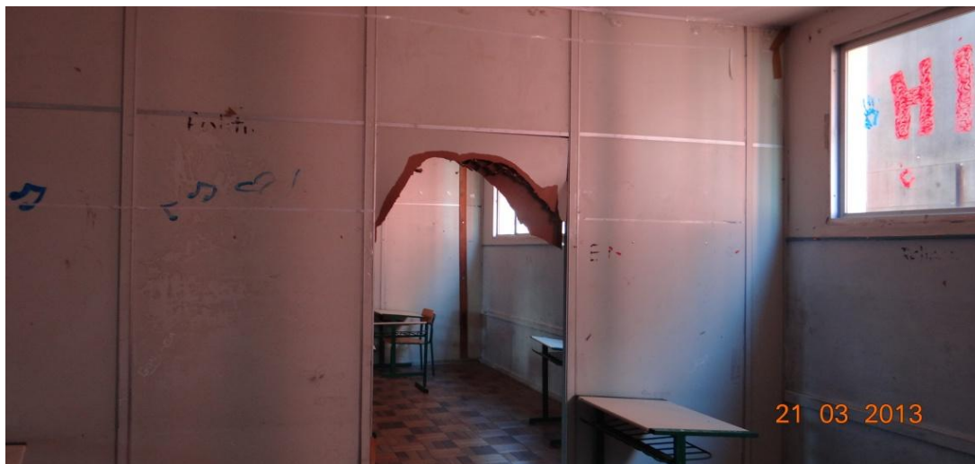
SALA DE AULA SEM USO, FACE AO ROMPIMENTO DA PAREDE DIVISÓRIA.
