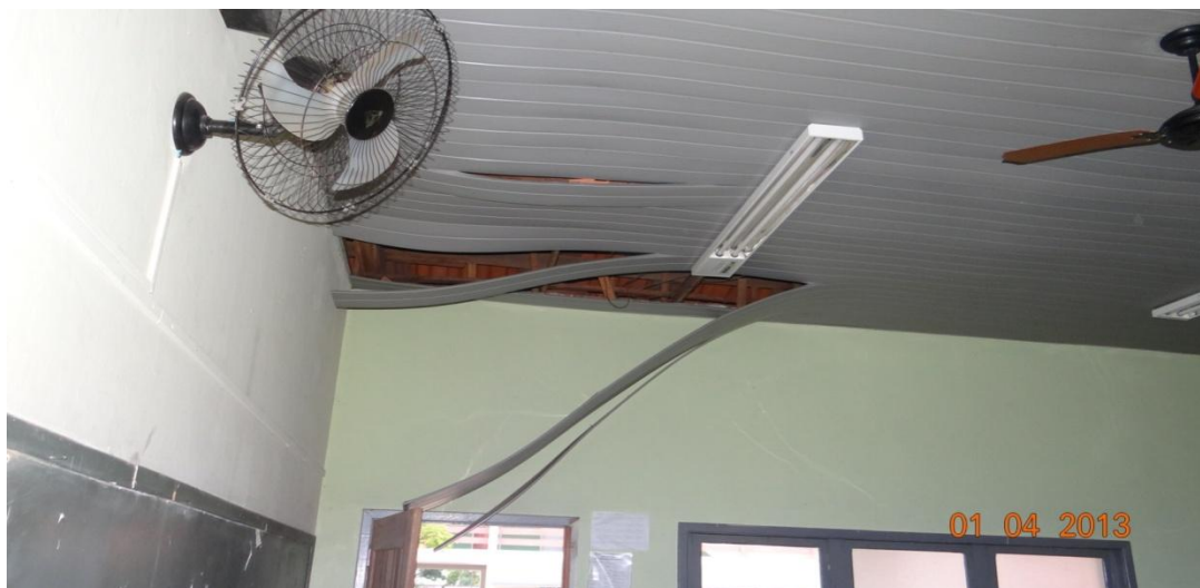
O FORRO DESTA SALA DE AULA DEMONSTRA O ABANDONO EM QUE FICOU ESTA UNIDADE ESCOLAR.
