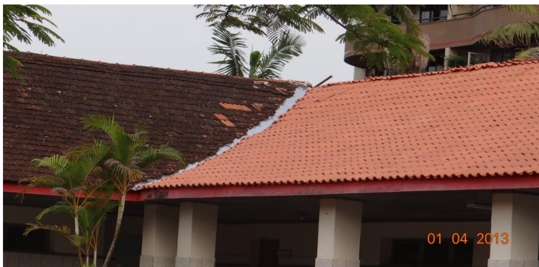
ACABAMENTO DOS SERVIÇOS APRESENTADOS SÃO DE PÉSSIMA QUALIDADE. SERVIÇO DEVERIA SER REFEITO.
