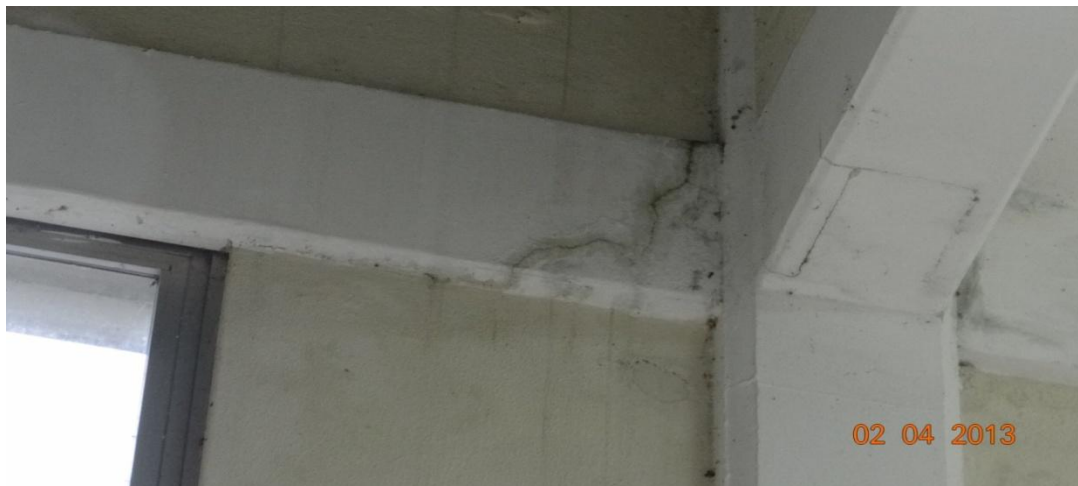
FISSURA NOS ELEMENTOS ESTRUTURAIS PROVOCAM INFILTRAÇÕES INDESEJADAS NA EDIFICAÇÃO.
