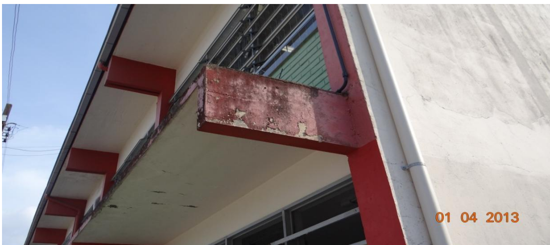
CORROSÃO DA ARMADURA JÁ É VISÍVEL NA MARQUISE. PROBLEMA QUE DEVERÁ SER CORRIGIDO PARA EVITAR A MAIOR DEGRADAÇÃO DO EDIFÍCIO.
