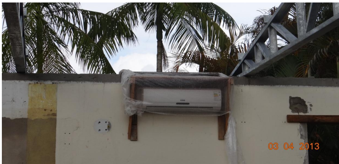
APARELHOS DE AR CONDICIONADO - TIPO SPLIT, NÃO FORAM RETIRADOS PELA EMPRESA CONSTRUTORA, DEMONSTRANDO DESLEIXO E FALTA DE FISCALIZAÇÃO.
