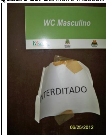
Foto 100_5044: Banheiro masculino interditado.
