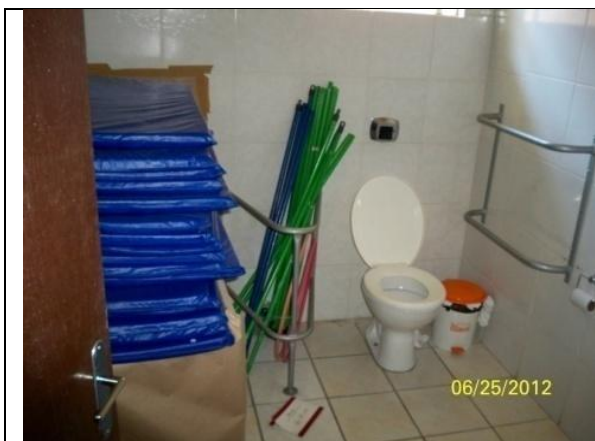
Foto 100_5040: Banheiro utilizado como depósito de materiais.
