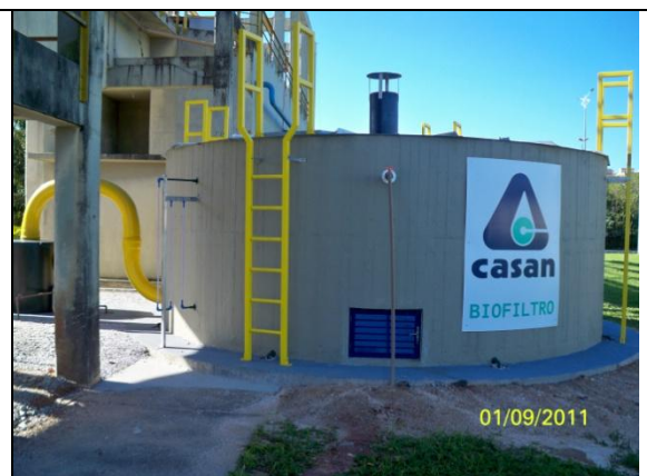
Foto 01/09/11: Biofiltro instalado e em funcionamento.
