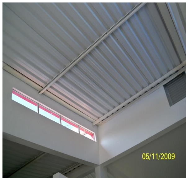
UBS de Areias – ausência de forro/telhado aparente
