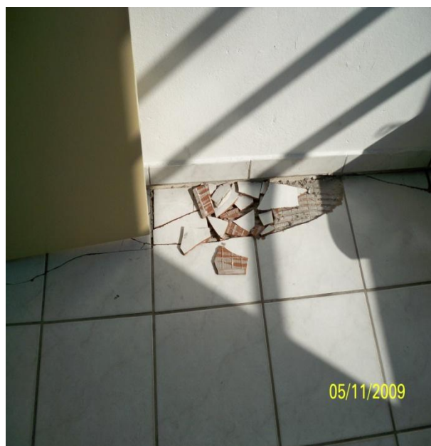
UBS de Areias – piso danificado da farmácia
