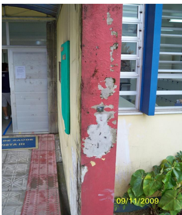
UBS de Bela Vista – fachada deteriorada
